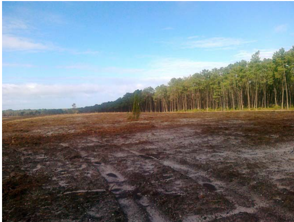
Preparatory works for the Planting Operation at Herdade da Bêbada and Herdade do Pinheiro Manso in Sines
